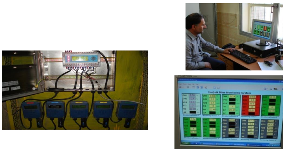
شکل ۲-۷- سیستم پایش گاز در یکی از معادن زغال سنگ
